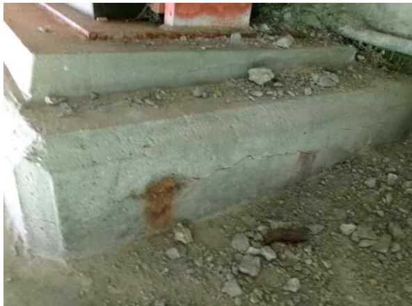
A1-SH5 받침콘크리트 균열(0.3mm/0.4m)
