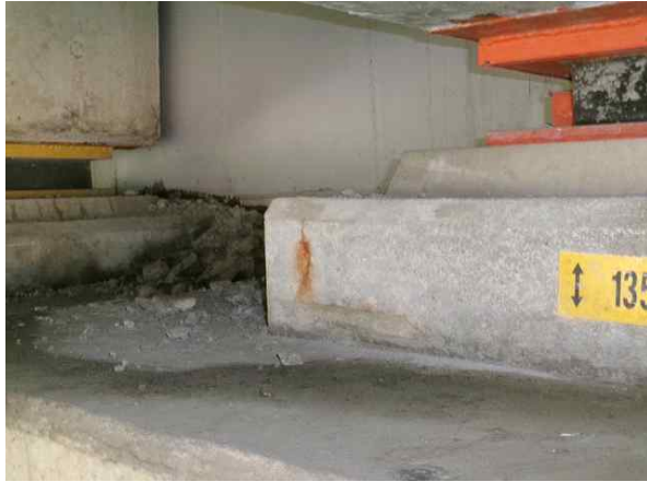
A1-SH5 받침콘크리트 파손(1.0×0.5)
