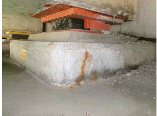
A1-SH5 받침콘크리트 파손(1.0×0.5)
