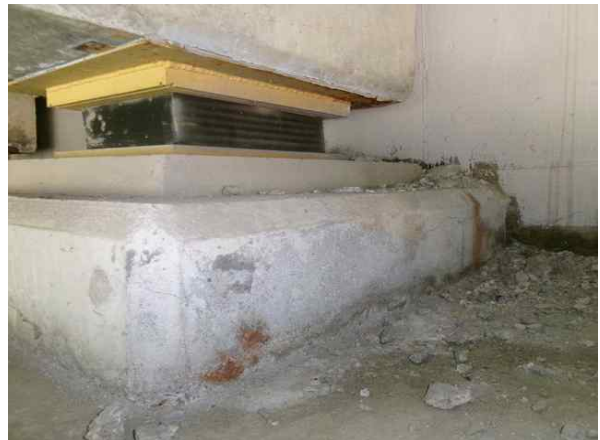
A1-SH6 받침콘크리트 균열(0.3mm/1.0m)
